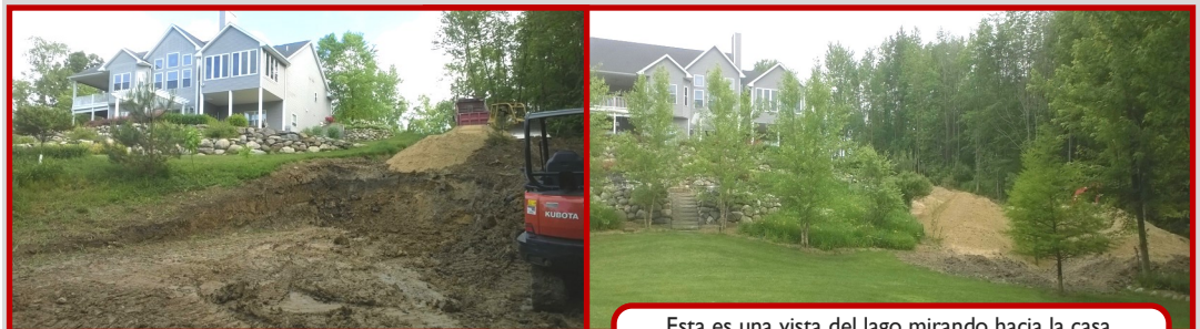
Esta es la nueva zona desagüe séptico antes de 42" de arena fueron transportados.
