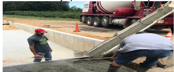
Echando el cemento para los nuevos muelles de carga en la antigua tienda
