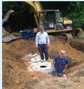
Buddy supervisa el trabajo de Scott en la instalación del tanque séptico de Krader.
